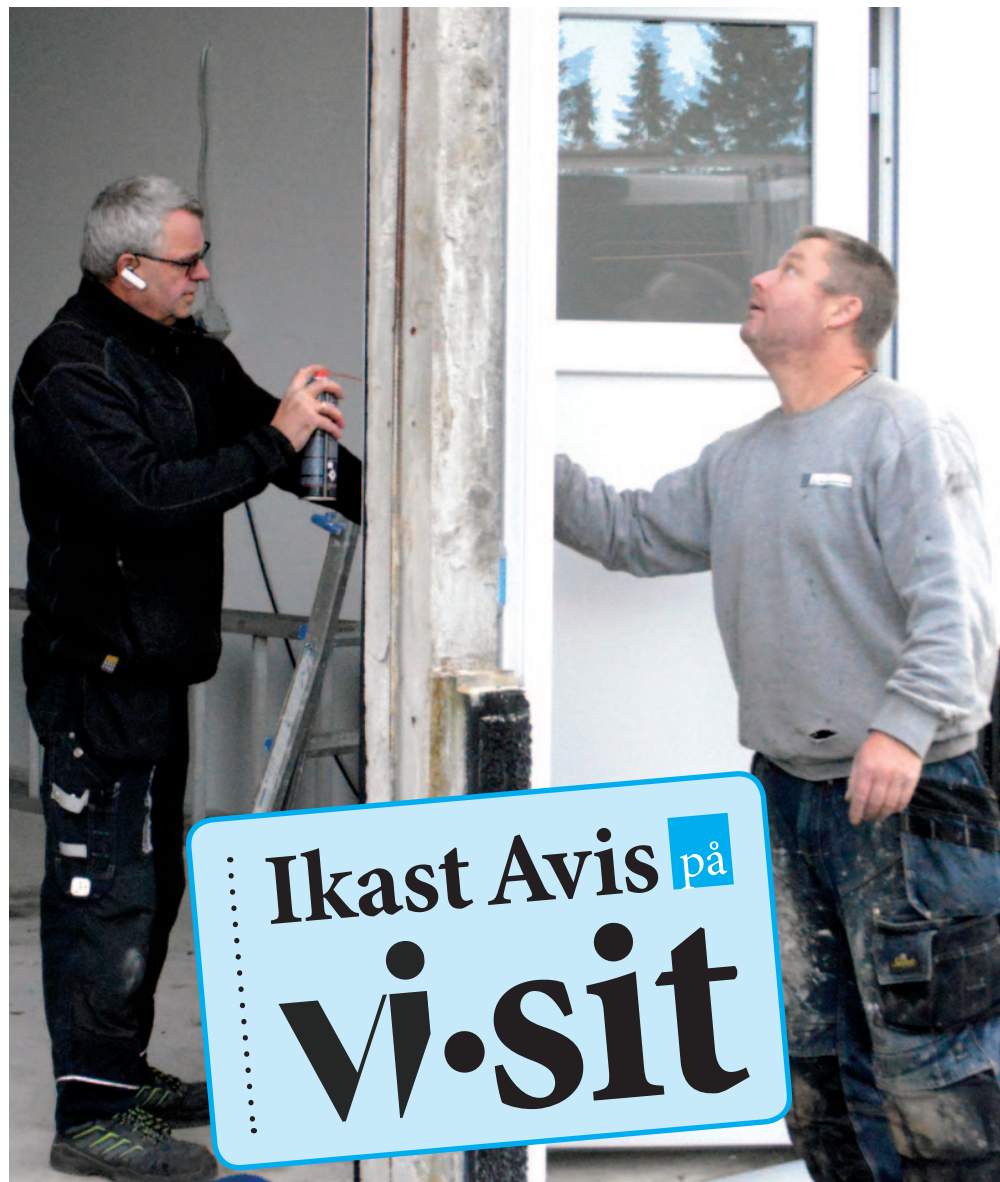
Steen Clausen og Gert Laursen er her ved at sætte en ny dør i hos en virksomhed i Nygade. Foto: Flemming Thulstrup
